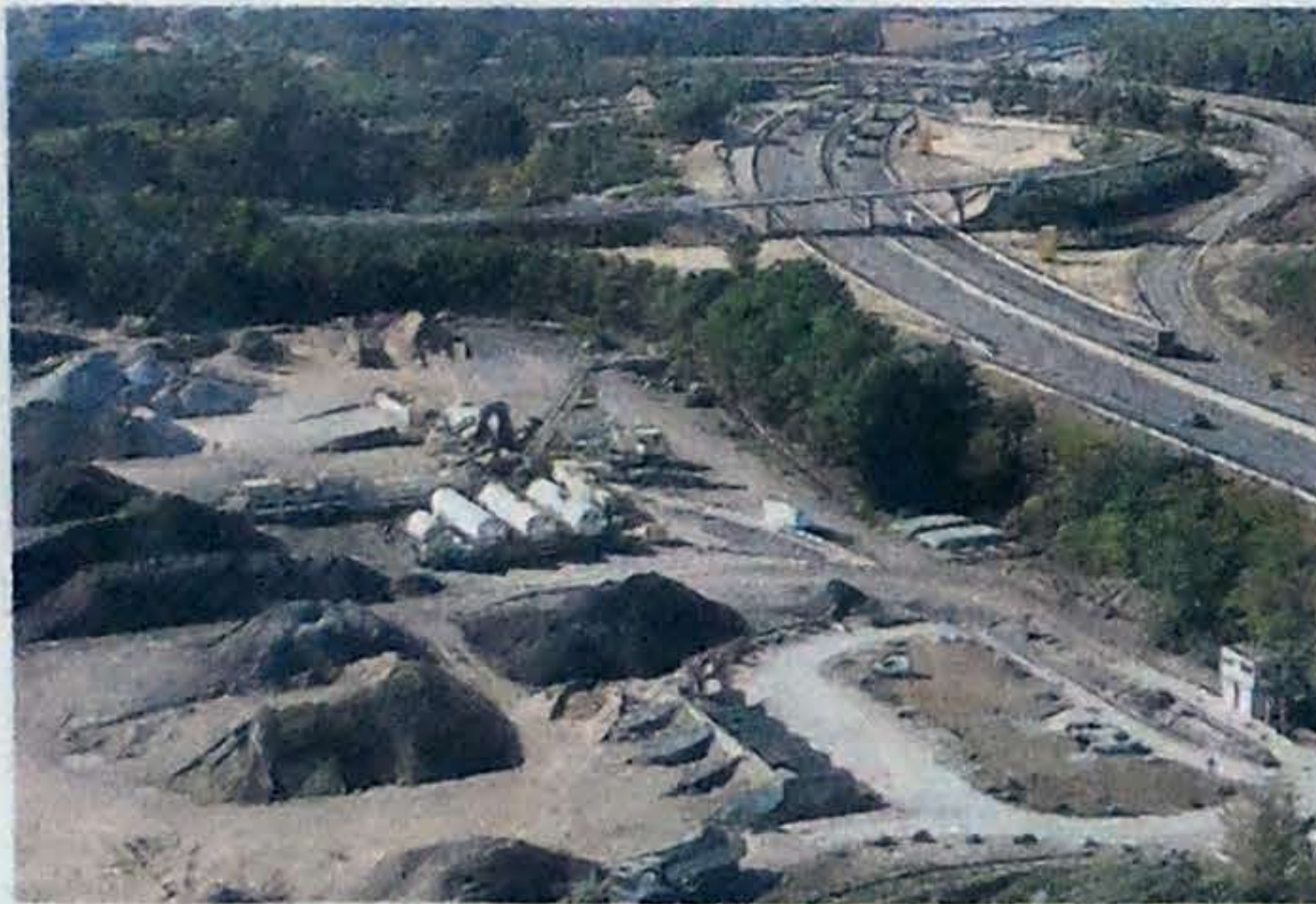
C'est une centrale comme celle qui a produit les enrobés de l'élargissement de l'A63 au Pays basque qui sera installée à Villeneuve-lès-Lavaur.
